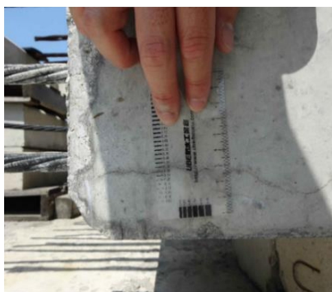
写真 2 曲げ試験体の桁端部に発生したひび割れ
