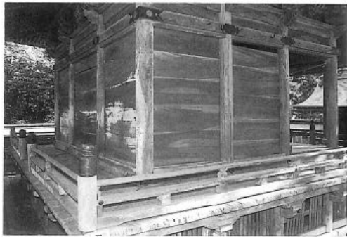
写真-19 背側面(背面中央間の高欄が切れている)
