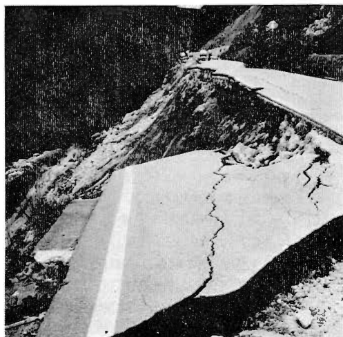
1. 九州横断道路；路床の破壊
